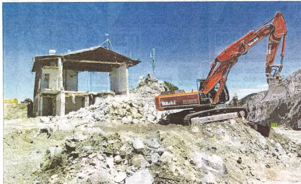
Die letzten Mauern der alten Bergstation wurden in den letzten Tagen eingerissen.
